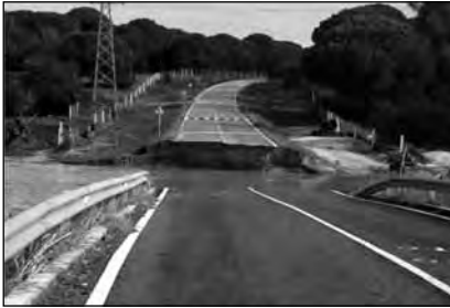
Carretera Villamanrique-El Rocío arrasada por el agua.
