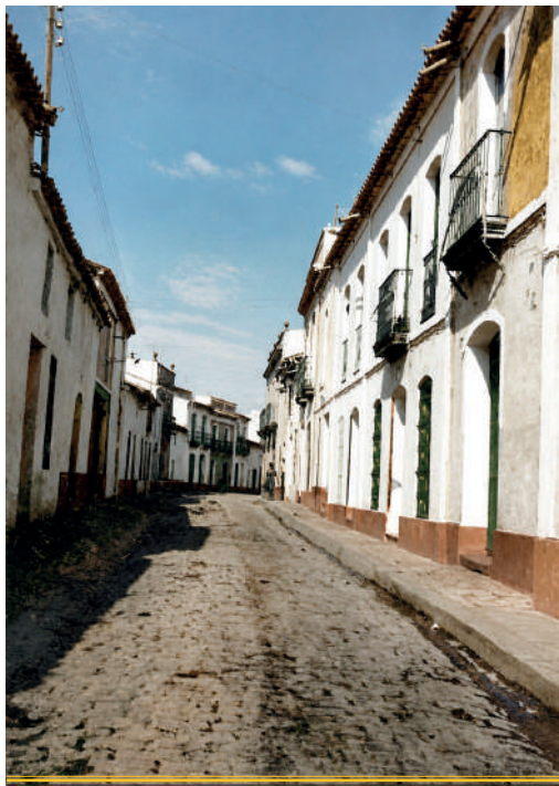
Calle Sevilla, mirando hacia la Plaza de los Bancos, arreglando su acerado izquierdo. Obsérvese el pavimento de ladrillos de barro colocados de canto. Foto original en blanco y negro. Cedida y restaurada por D. Juan María Suárez Sierra.
